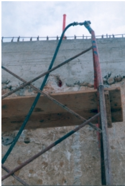
Σχήμα 3-16: Θραύση του τοίχου τοπικά και αποκάλυψη του αποκλισιόμετρου ακριβώς στη διεπιφάνεια μεταξύ παλαιάς και νέας σκυροδέτησης.
