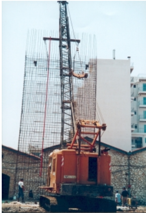
Σχήμα 3-4: Τοποθέτηση του κλωβού οπλισμού. Διακρίνεται ο A-1 αποκλισιομετρικός σωλήνας που είναι αναρτημένος από τον κλωβό οπλισμού
